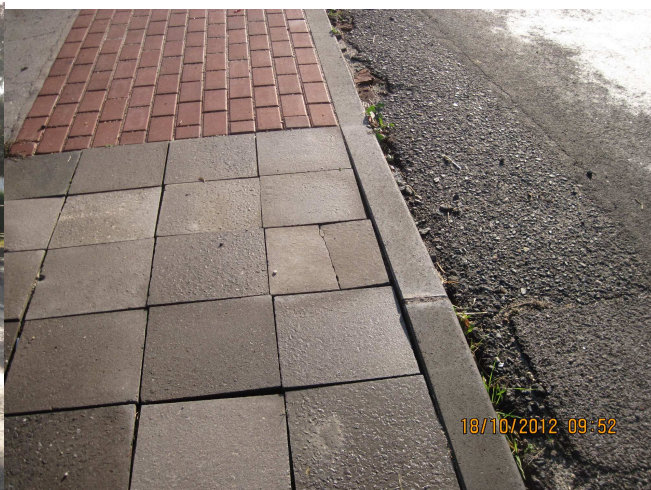
Ono to je špatně vidět, ale popraskané a promáčklé dlaždice na novém chodníku jsou dílem sobeckého a omezeného člověka.
